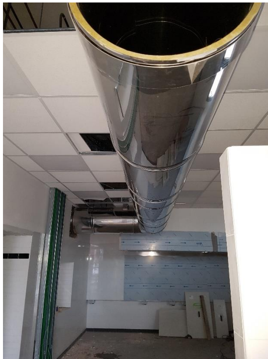
Brew Restaurant Doppio Malto - Verona: realizzazione impianto di estrazione (cappe compensate cucina)
